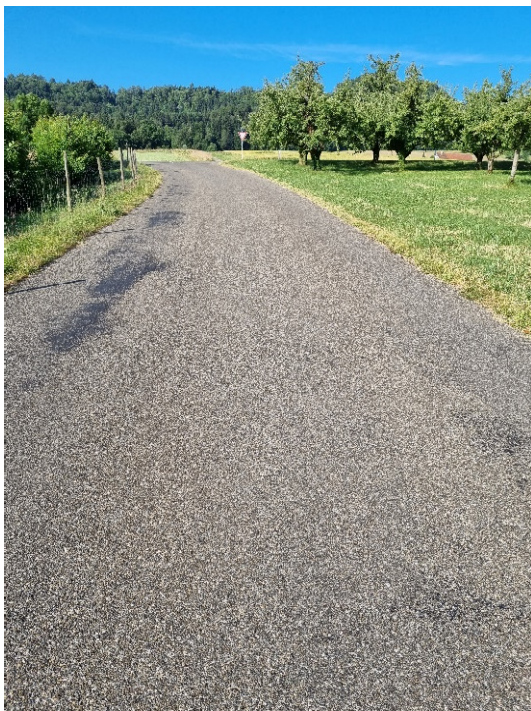
Abbildung 12: Bitumen an Oberfläche
